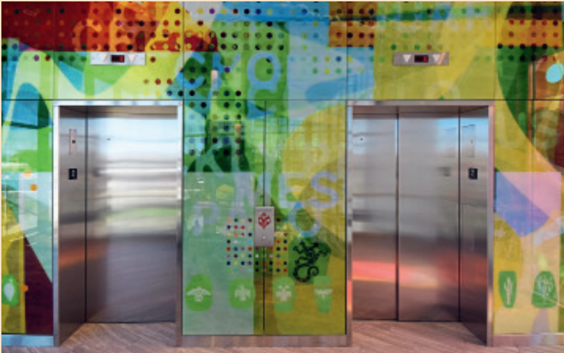
Gesamtaufnahme des Fahrstuhls im Erdgeschoss.
